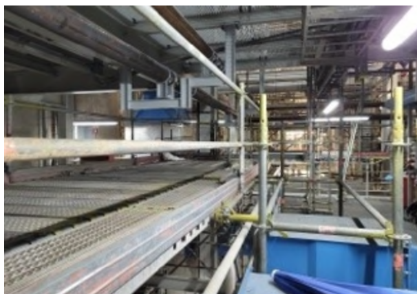
Auf einem Gerüst mit vielen Rohrleitungen
